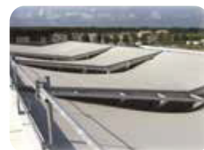
SIAAP Achères Station d'épuration Couverture 12 500m 2
