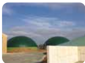
GAEC de ROOVER (56) Méthanisation 500kW Digesteur et Post Digesteurs Ø20m
